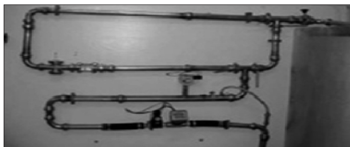
Rys. 2. Stanowisko do mycia w systemie CIP
