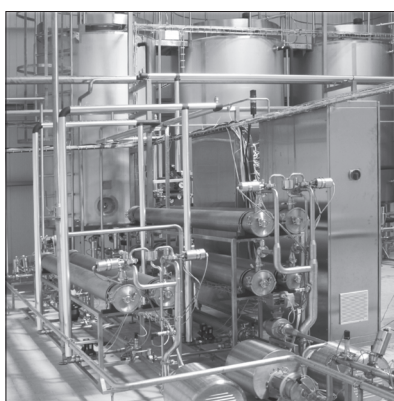
Rys. 3. Widok rzeczywisty instalacji ultrafiltracyjnej (I stopień po prawej stronie, II stopień po lewej stronie)
